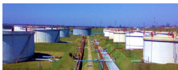
Fig. 3.1. Depozit de rezervoare pentru stocarea țițeiului[10].
