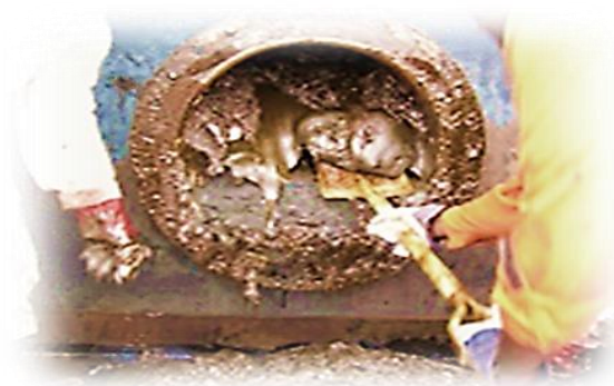
Fig. 4.1. Șlam petrolier pe fundul rezervorului de țiței (intervenție manuală) [6],[8]
