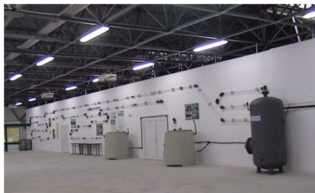
Fig. 1. Poligon experimental pentru studiul și cercetarea sistemelor vacuumate de canalizare tip ISEKI.
